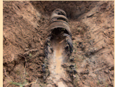
野焼きにより焼失した埋設管
