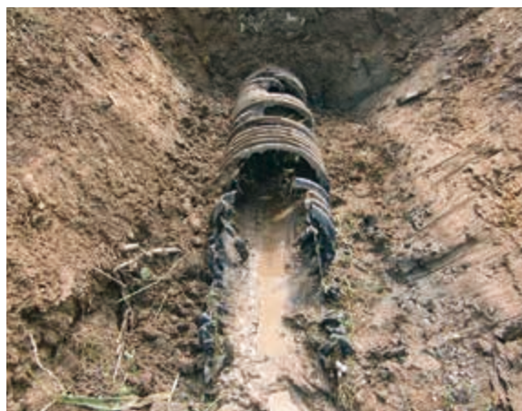
野焼きにより焼失した埋設管
